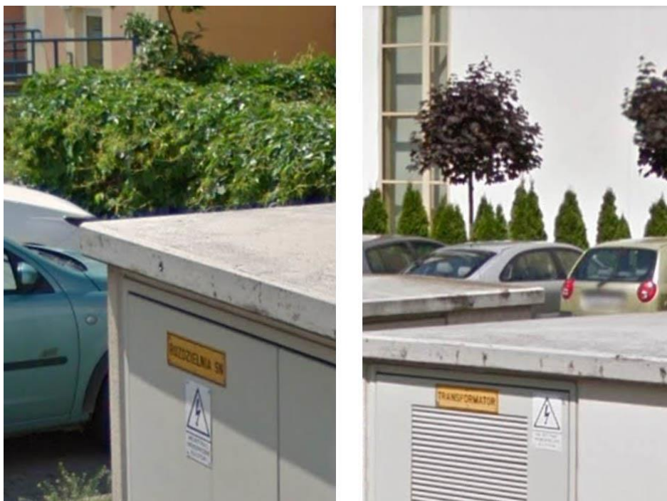
Zdjęcie 7 Stacja transformatorowa SN z rozdzielnią SN
