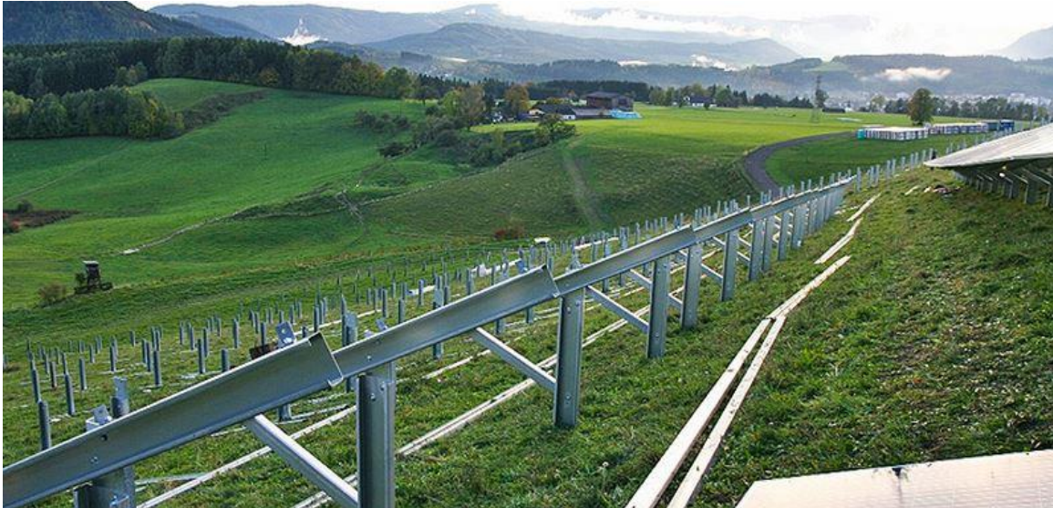
Zdjęcie 3 Konstrukcja przeznaczona do posadowienia paneli fotowoltaicznych.
