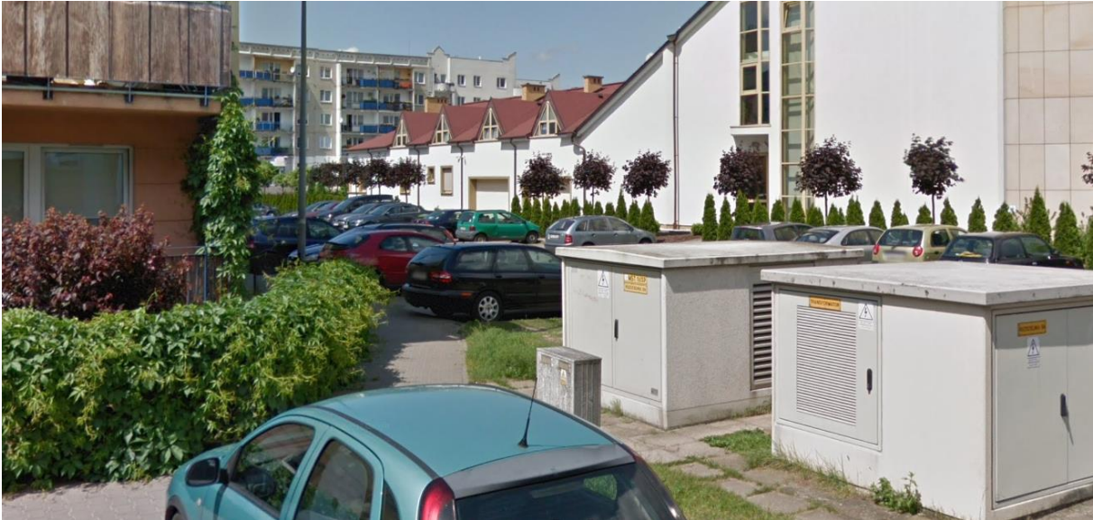
Zdjęcie 5 Standardowe stacje kontenerowe w otoczeniu zabudowy.
