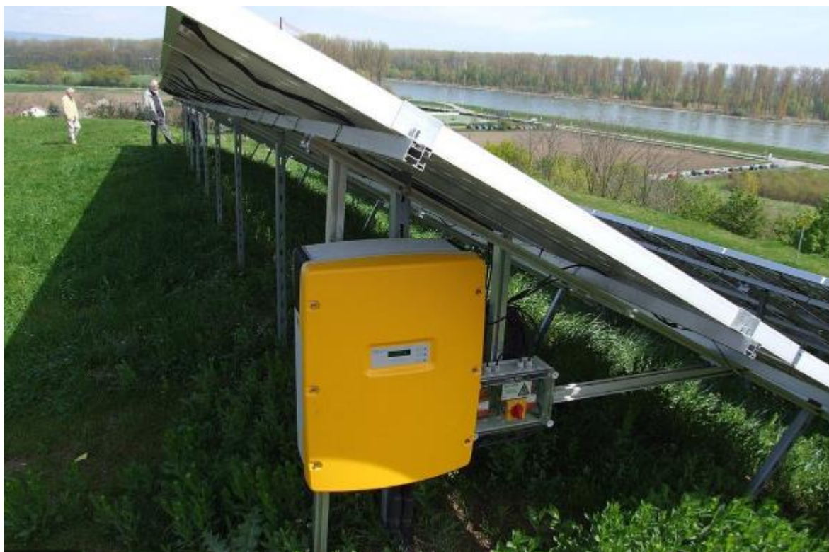
Zdjęcie 4 Przykładowy inwerter farmy fotowoltaicznej.
