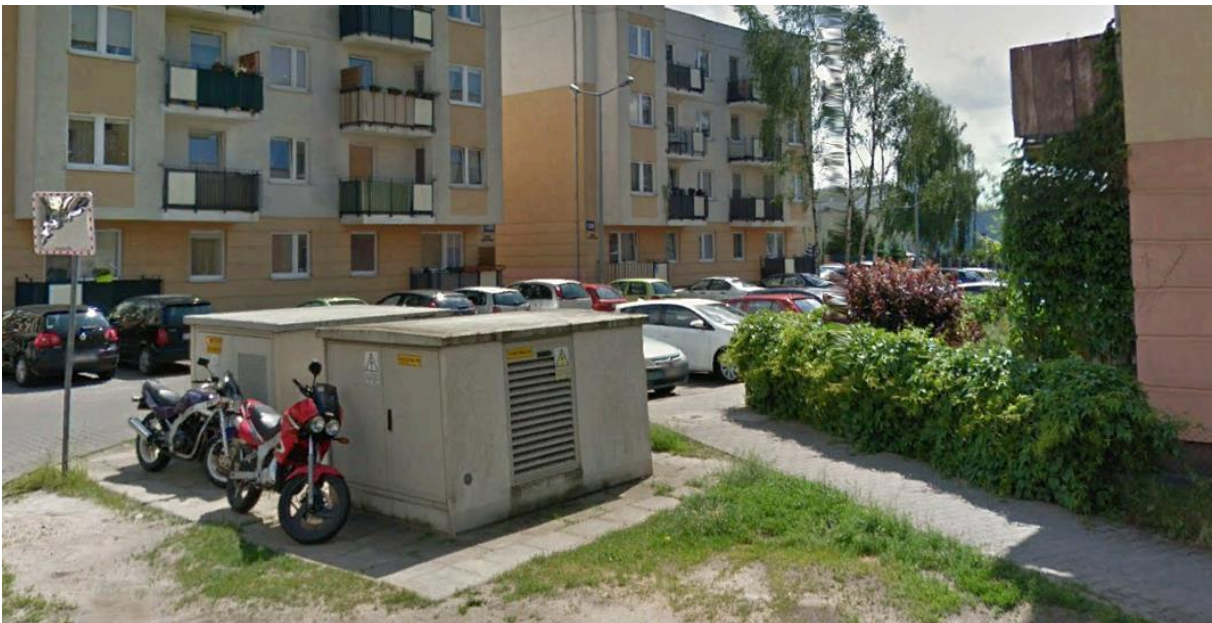
Zdjęcie 6 Stacje transformatorowe w otoczeniu zabudowy.
