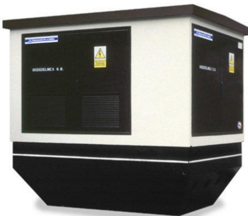
Rysunek 5 Widok na przykładową stację transformatorową.
