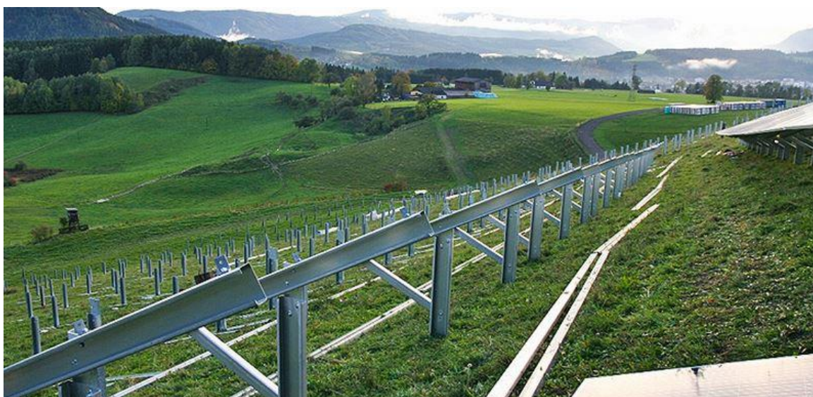
Zdjęcie 3 Konstrukcja przeznaczona do posadowienia paneli fotowoltaicznych.
