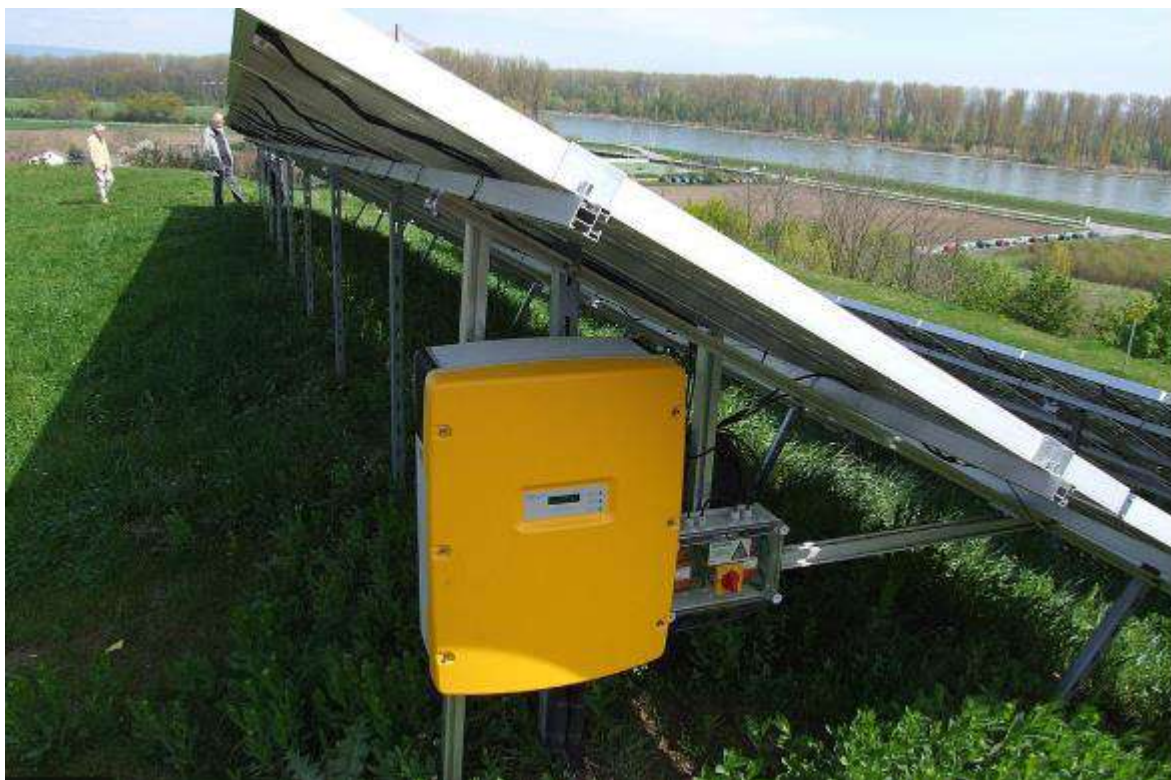
Zdjęcie 4 Przykładowy inwerter farmy fotowoltaicznej.
