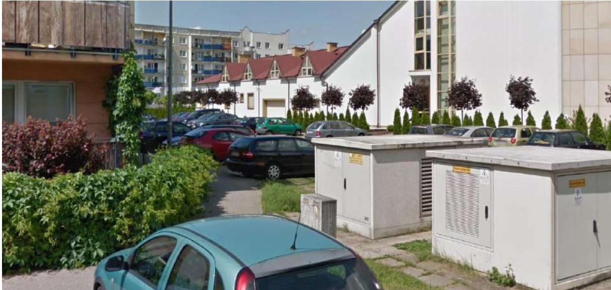
Zdjęcie 5 Standardowe stacje kontenerowe w otoczeniu zabudowy.
