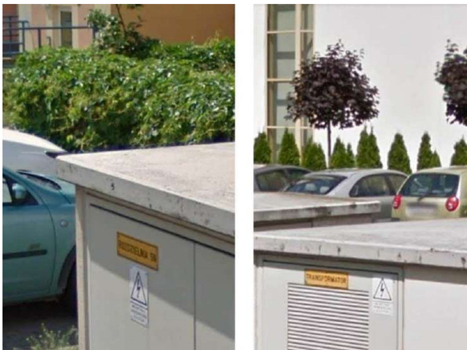
Zdjęcie 7 Stacja transformatorowa SN z rozdzielnią SN
