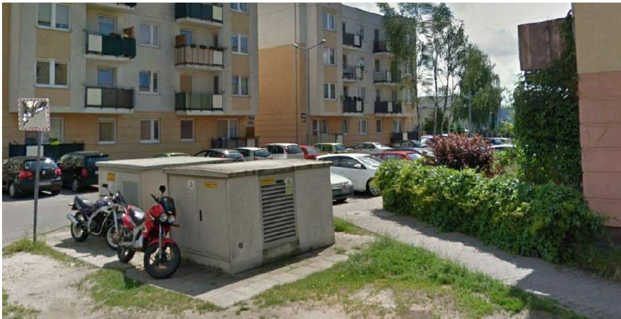
Zdjęcie 6 Stacje transformatorowe w otoczeniu zabudowy.
