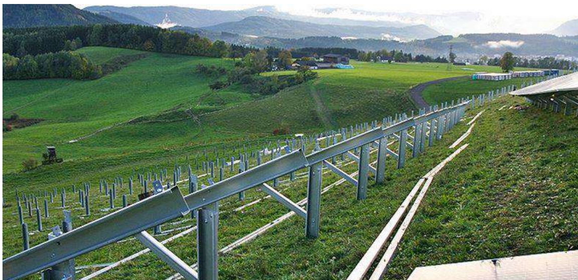
Zdjęcie 3 Konstrukcja przeznaczona do posadowienia paneli fotowoltaicznych.
